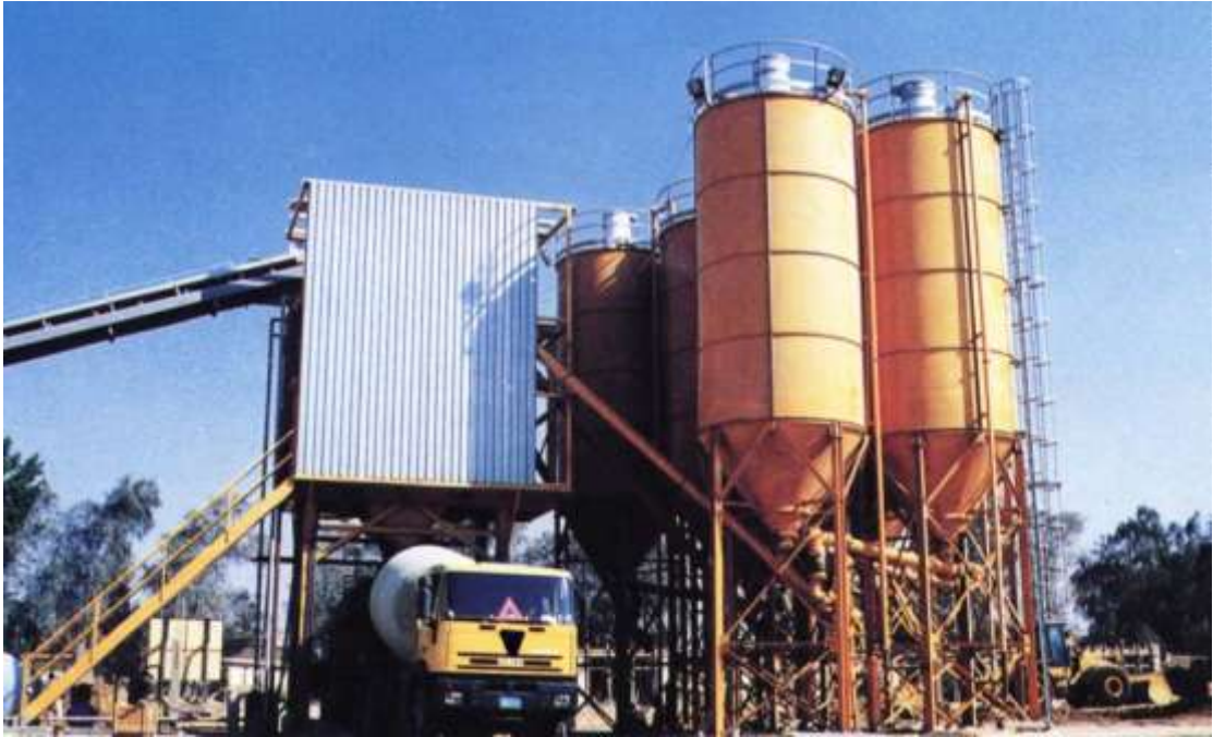
صورة رقم (3): محطة خلط مركزية لإنتاج الخرسانة
